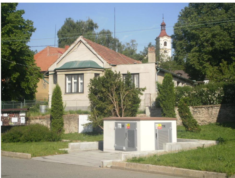
Nová trafostanice na návsi byla instalována roku 2010.
